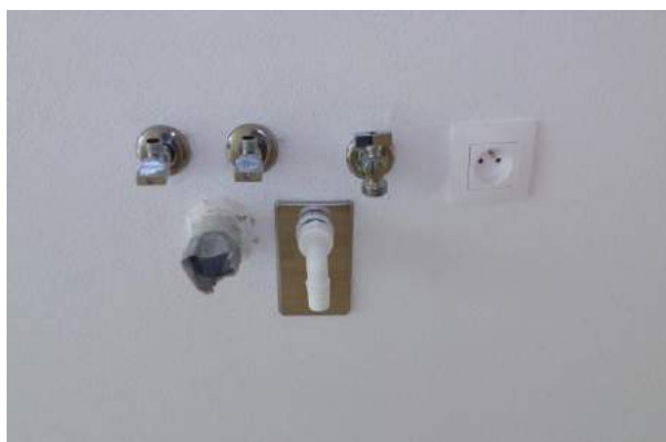
provedení vývodů za kuchyňskou linkou pro dřez a myčku – ve standardu jsou rozvody zasekané pod omítku
